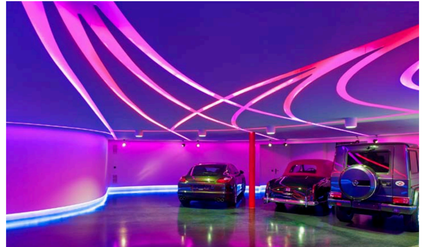
Abb.: Über RGB-steuerbare Lichtvouten an der Decke entstehen farbdynamische Bilder, die an Fahrspuren erinnern. Auch für die Garage sind mehrere Szenarien abrufbar.
